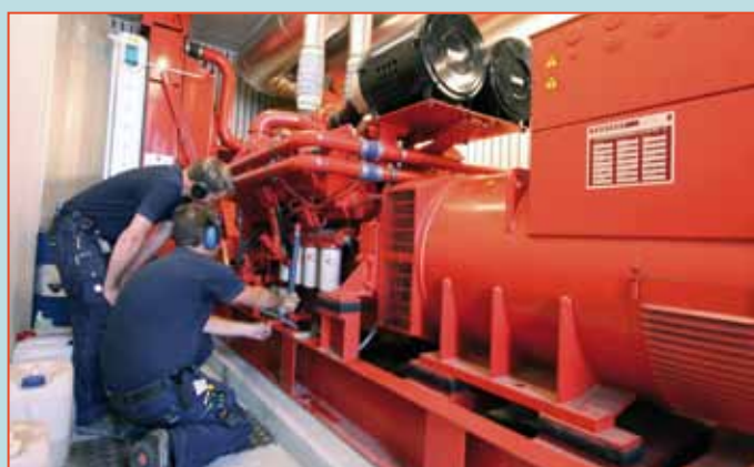
Faszinierende Einblicke in das technische Innenleben des BKH organisieren für Sie die Mitarbeiter der Haustechnik.
